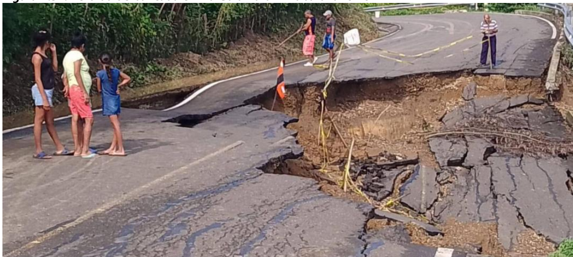
Figura 2.32. Pérdida de bancada en vía Guaimaral – Tubará año 2022
